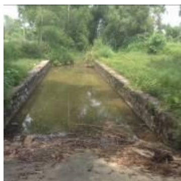
Mặc dù nước từ hồ chảy qua tràn, dốc nước vẫn bị ngập do hạ lưu vị bồi lấp
