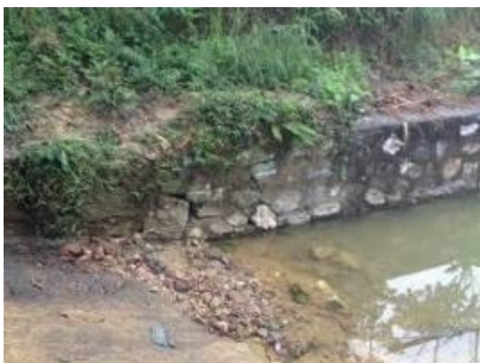
Hình 19 - 45: Tường bên bị hư hỏng
