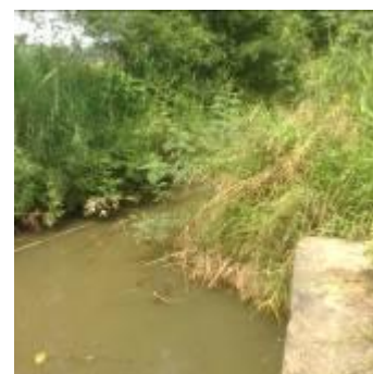
Kênh dẫn tràn xả lũ bị khóa lấp do cây cối và tre nứa mọc dày
